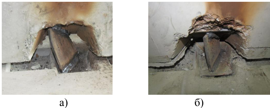
Рис.4. Общий вид разрушения узлов (а, б)
